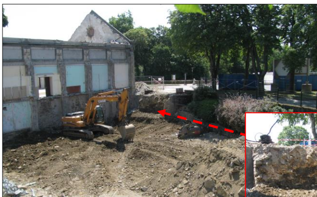
26 juillet 2012 : près d'une tour du XII e s. redécouverte et éventrée, on s'active à niveler et à faire disparaître les débris mis au jour ; au fond, les anciennes halles.
